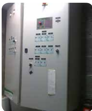
Mise en conformité du tableau électrique des serres (TGBT : 18 000€).
