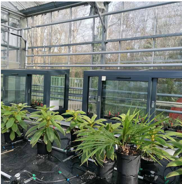
••• Installation de 2 cellules de multiplication en serres techniques
