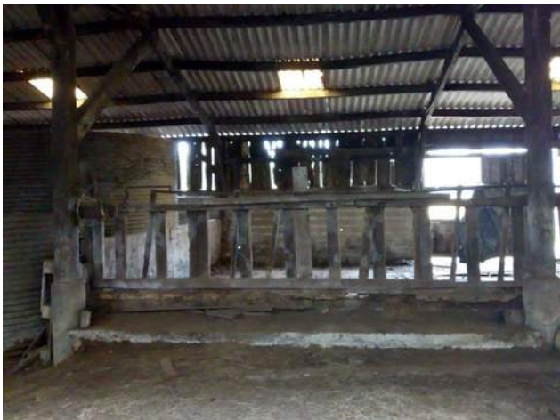
Un des cornadis en bois mal en point
