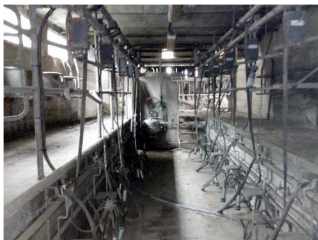
Salle de traite avec plafond en amiante
