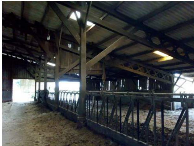
Des cornadis métalliques qui ne sont guère en meilleur état.
