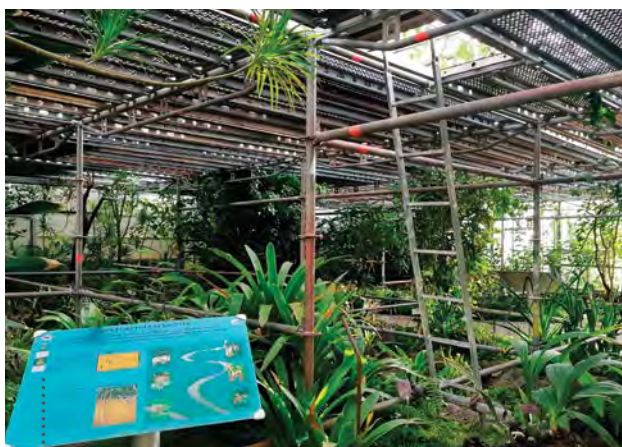
Remplacement de la toile d'ombrage en serre 4 (pose d'un échafaudage sur toute la serre)
