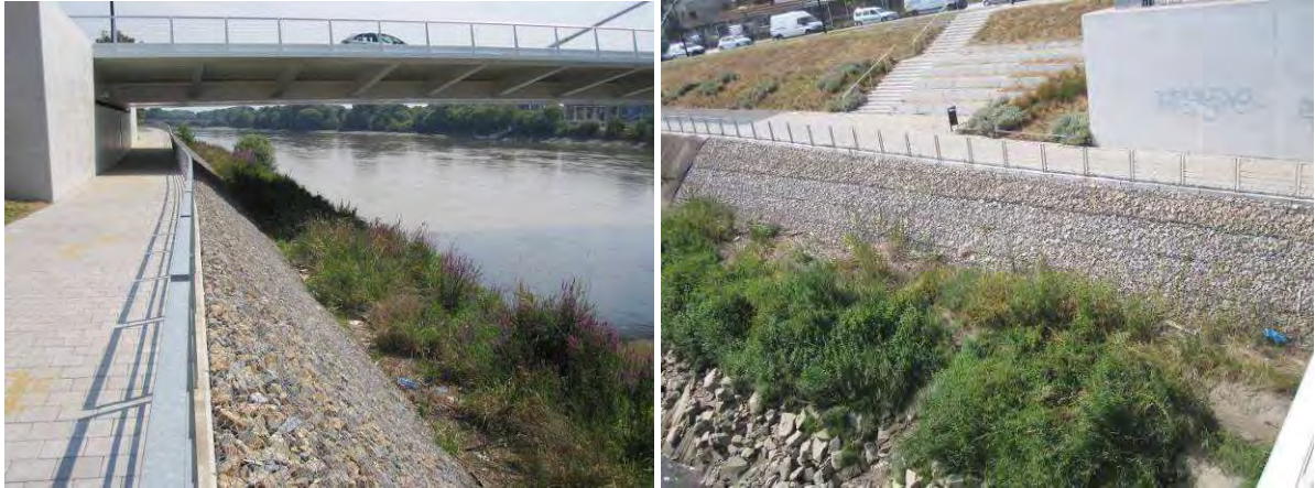
Vues des aménagements de la berge à l'arrivée nord du pont E. Tabarly, le 29 juillet 2011 (photo de gauche), et en juillet 2013 (photo de droite)
