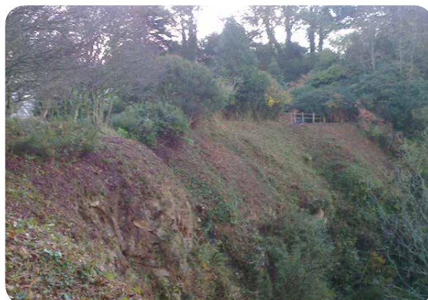
Débroussaillage de la falaise près de l'étang du pavillon d'accueil et création d'un chemin d'accès pour faciliter le travail d'entretien de l'étang et de la falaise © Olivier Le Meur (Brest métropole)
