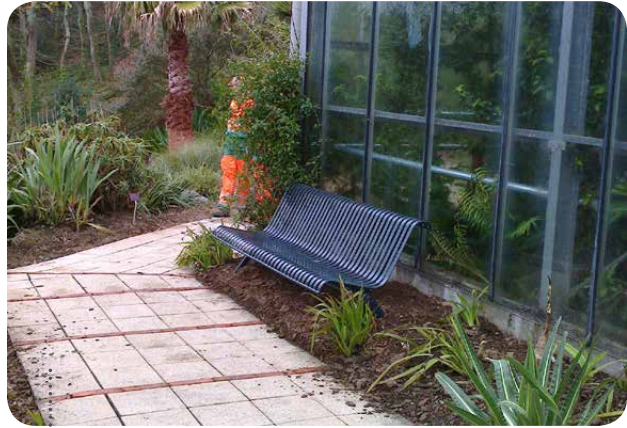
Réaménagement du mobilier et nettoyage des allées (dalles et sablées) et des massifs autour des serres pédagogiques © Olivier Le Meur (Brest métropole)
