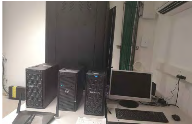
Nouvelle salle des serveurs © Sylvie Magnanon (CBN de Brest)
